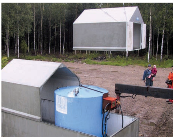
Takhalvorna monteras och infästas i botten- delen. Tack vare låg vikt kan varje takhalva även hanteras med vanlig traktorlastare. Fogning sker med medlevererad fogmassa.
